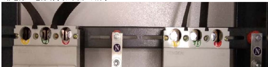
图 28 双电源控制设备电源进线端子
