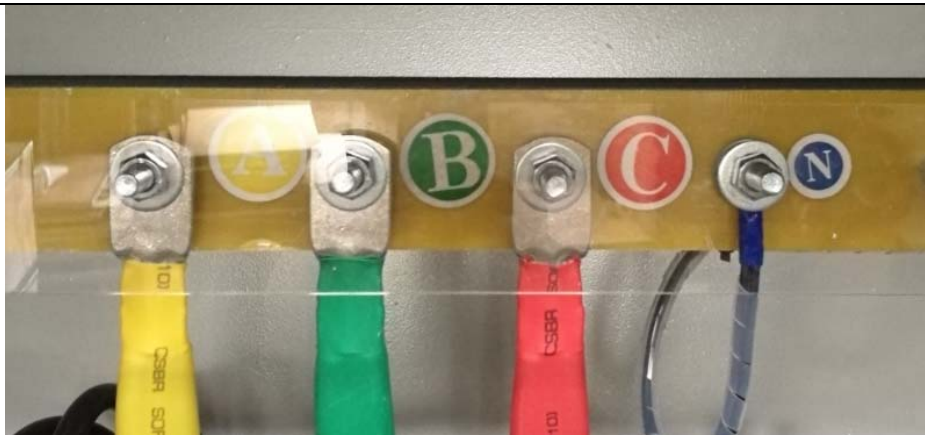
图 5-2 电源进线接在胶木板上
